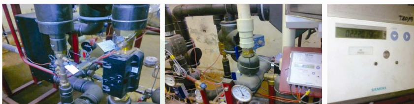
Domová výmenníková stanica- KOST
